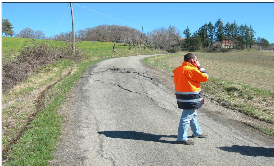
Figura 3: Crepe sulla strada comunale. Sopralluogo del 21/03/2013.
