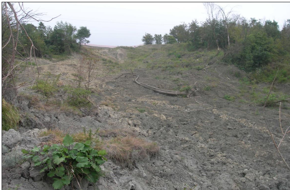
Figura 10bis: Panoramica della frana al 28/08/2014 scattata circa 100 m a valle della strada della quale si intravede la rete nera di demarcazione della nicchia dal tracciato delle auto.
