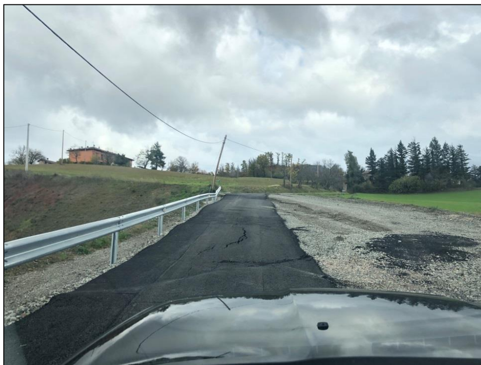
Figura 22: Nuovo dissesto. Foto del 17-11-2019.
