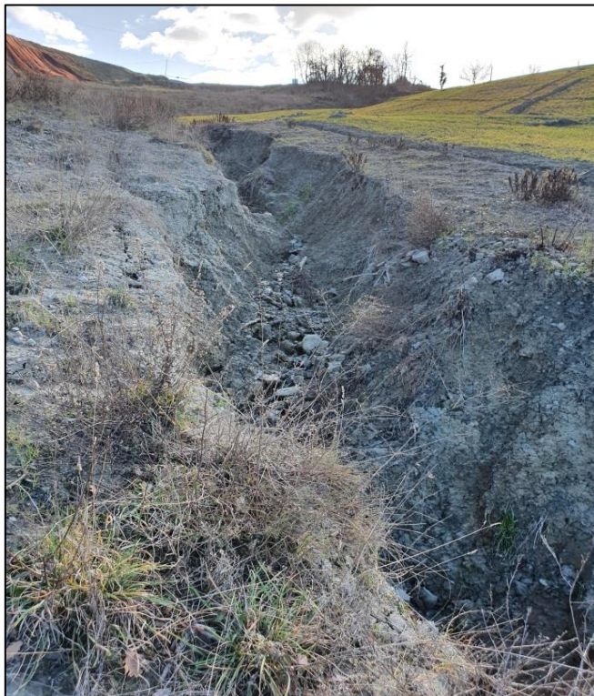
Figura 30: Fenomeni di erosione nel fosso situato sul corpo della frna alla base dei rilevati artificiali.
