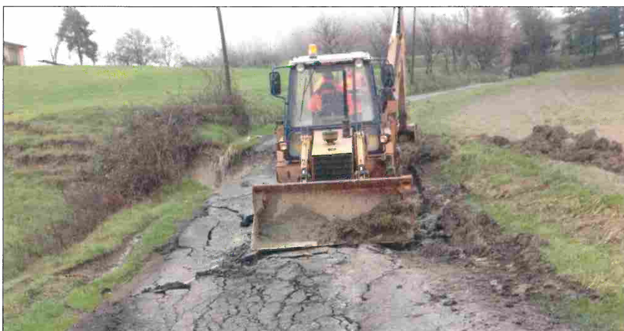
Figura 6 – Stato del tratto della strada comunale Via San Vincenzo in esame al 07/04/2013
