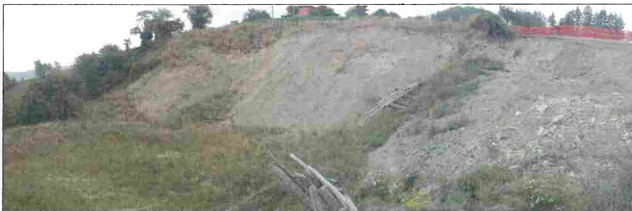
Figura 9 – Stato della scarpata principale e della zona di abbassamento al 28/08/2014
