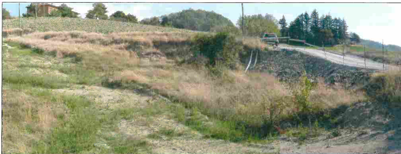
Figura 7 – Stato della testa della frana in esame al 26/09/2013
